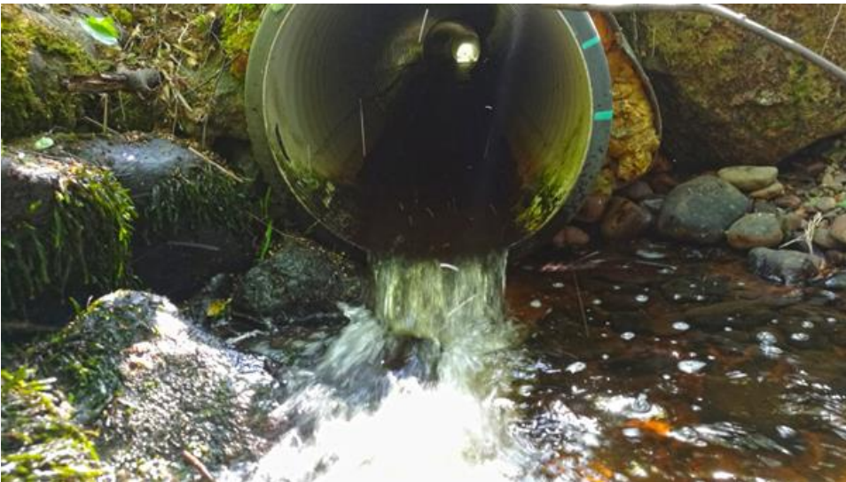
Kuva 2. Puroon liian korkealle asennettu tierumpu estää kalojen pääsyn kutupaikoille. Kuva: Jussi Aaltonen, Valonia.
