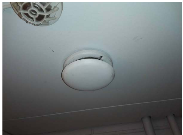
142. Poistoilmaventtiili (väärä malli).
