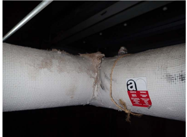
116. Mahdollisesti asbestia sisältäviä eristeitä.
