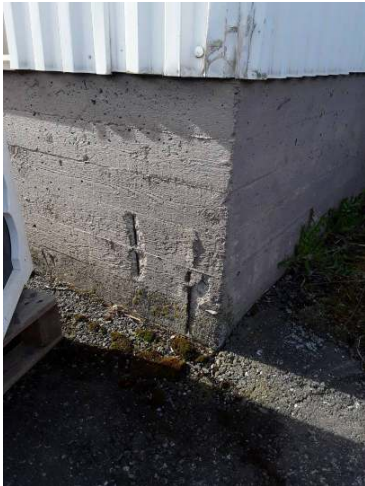
18. Sokkelissa raudotteita pinnassa
