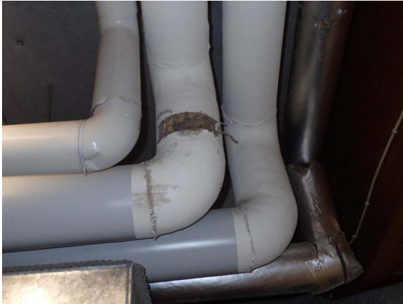
115. Mahdollisesti asbestia sisältäviä eristeitä.
