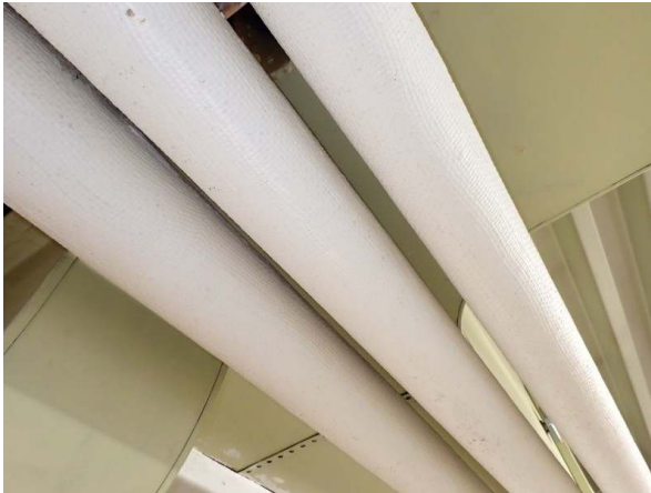
127. Putkieristeet saattavat sisältää asbestia.
