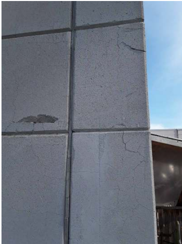
44. Siporexin halkeilua ja saumat heikossa kunnossa
