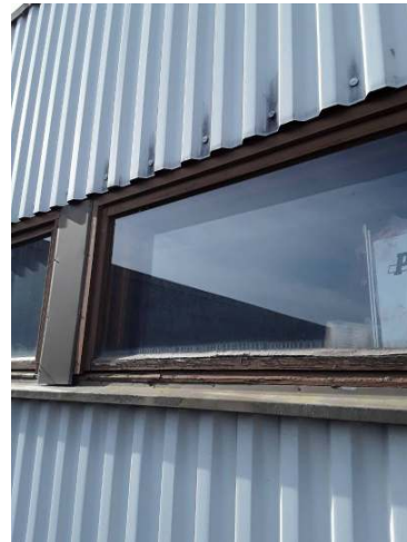
56. Ikkunan pinnat kuluneita
