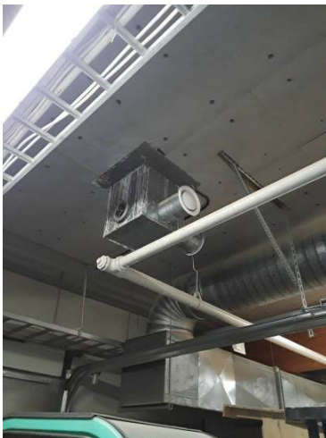
71. Katossa vanhoja vuotojälkiä
