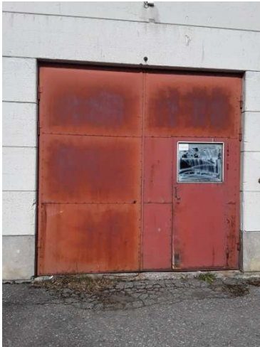
70. Ovessa kulumaa ja ruostumaa
